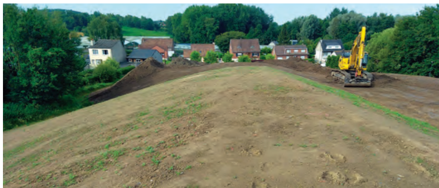
Mai 2024, apport de terres des chantiers locaux et travaux de terrassement des modelés
